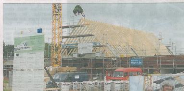
Baustelle Betonstraße Heidgraben. Dort entsteht ein MarktTreff mit Laden, Postpoint, Bankautomat, Backshop, Café und Friseur.
